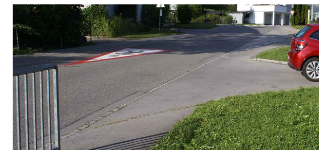
Sicherungseinrichtung und Warnhinweis auf Fahrbahn – Indizien für Gefährdungen durch den Kfz
